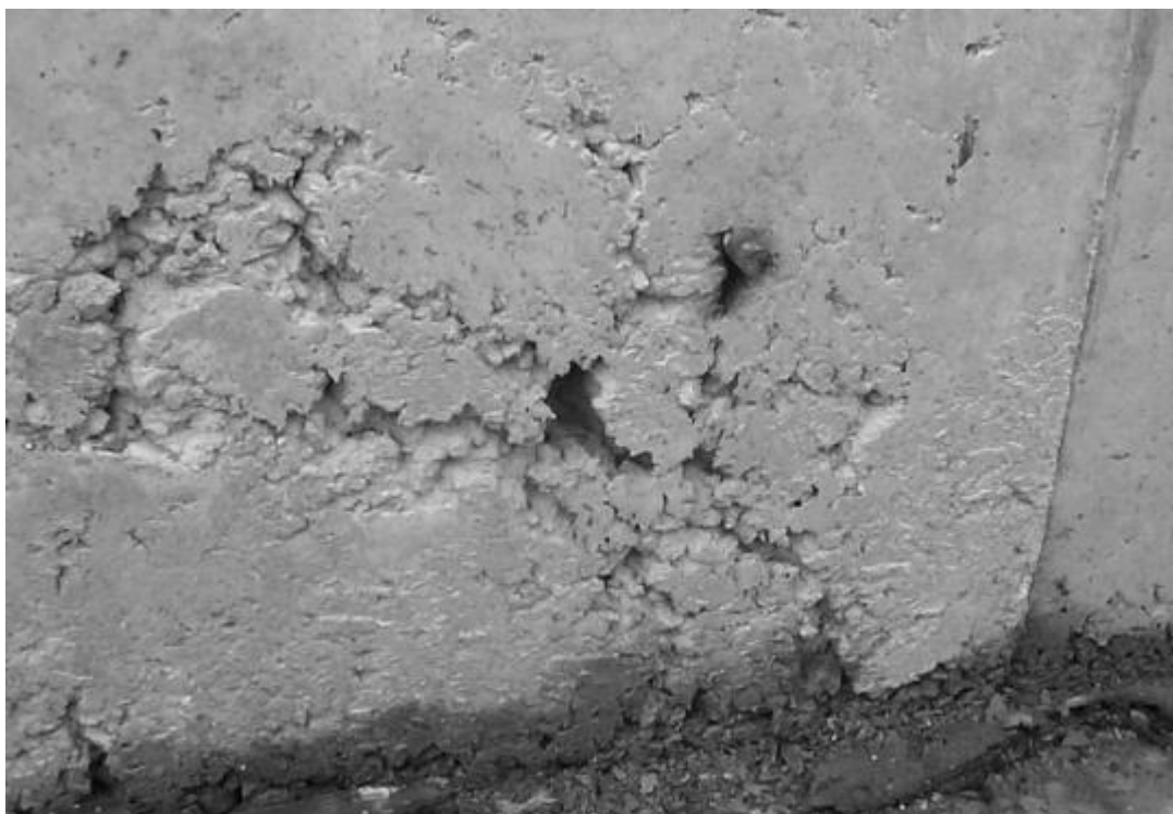
Рис. 4. Непровибрированные участки стены
