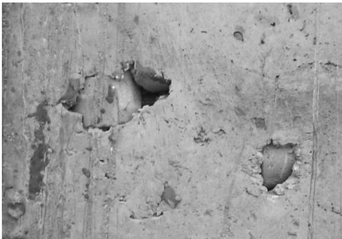
Рис. 5. Зависание бетонной смеси в зоне «сухарей»
