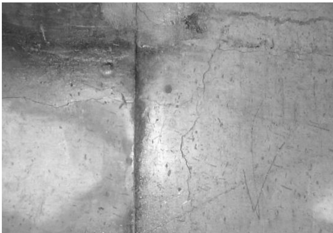
Рис. 6. Усадочные трещины на поверхности стены автомобильного тоннеля
