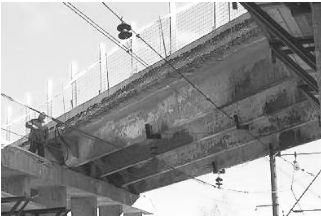
Рис. 7. Разрушение бетона пролетного строения
