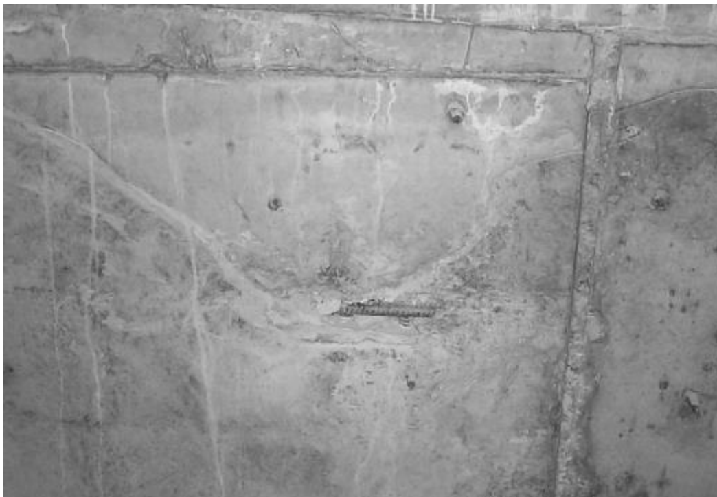
Рис. 1. Участок стены с оголенной арматурой
